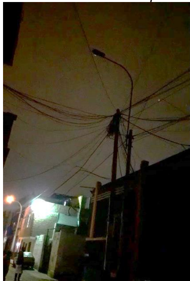
Fotografía 6.3-2 Poste de Luz Inoperativo - Jirón Libertad
