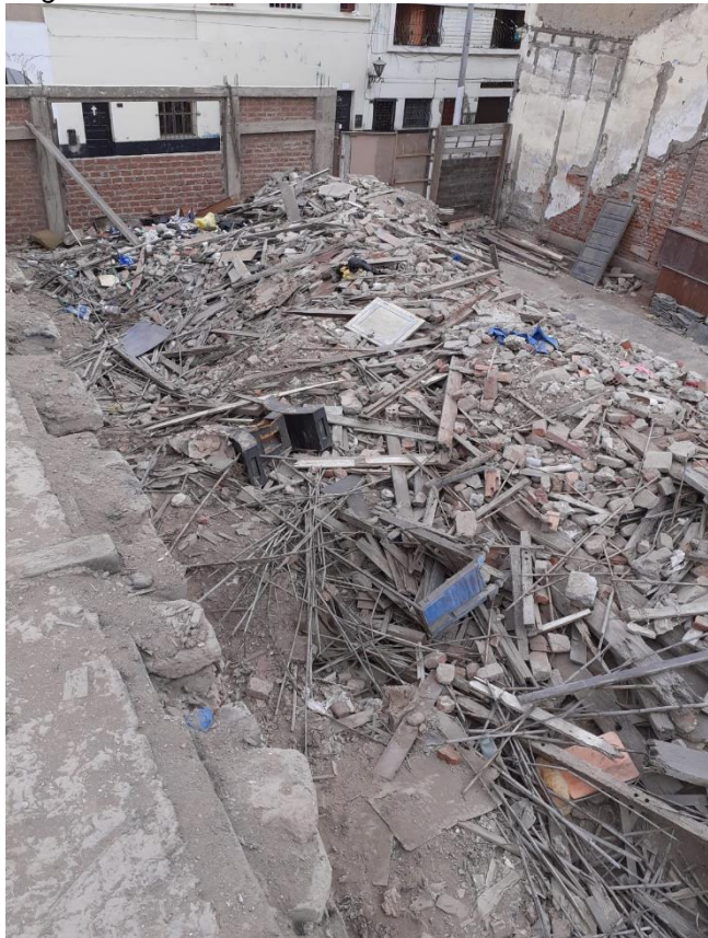
Fotografía 6.3-1 Vivienda caída en el Jirón Libertad
